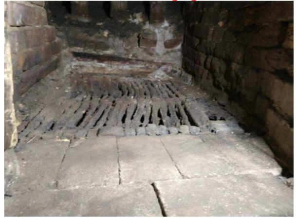
De roosterbaren van ketel 1 zijn 'op' en dienen volledig vervangen te worden. (foto Stichting Restauratiewerkplaats Schiedam)
