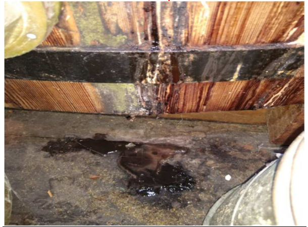
Het koelvat van ketel 1 lekt en heeft zijn beste tijd gehad. (foto Stichting Restauratiewerkplaats Schiedam)
